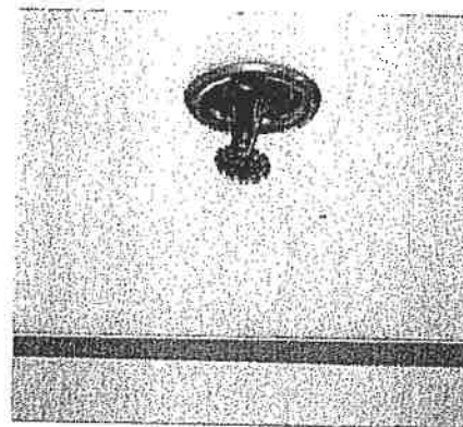
สปริงเกอร์ฉีดน้ำอัตโนมัติ
